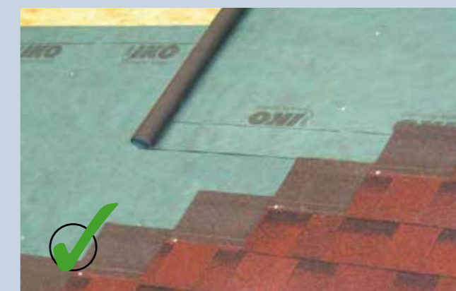
Zdjąć stare gonty i rozpocząć montaż od nowa przy użyciu płyt OSB, poszycia i gontów Cambridge Xtreme 9,5°.
